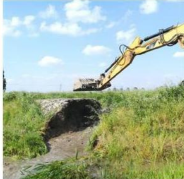
L'enorme galleria scavata dalle nutrie sull'argine del Focchiarà
