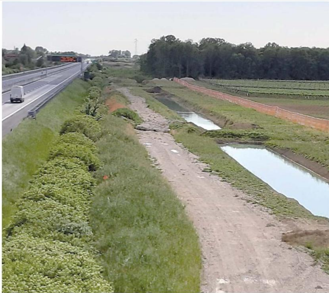
Il canale di gronda in costruzione lungo la A4 a Loncon di Annone Veneto
