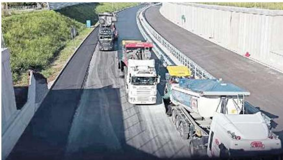
IL CANTIERE Lavori in corso, e in via di ultimazione, sul tracciato della Superstrada Pedemontana Veneta
