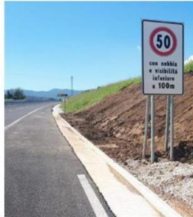
Il versante ripristinato dopo la frana dovuta alle piogge sulla Spv
