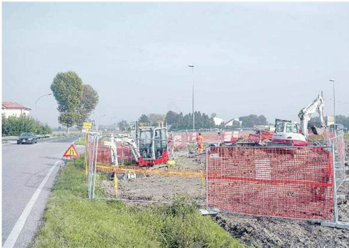
CANTIERE Avviati i lavori per la rotatoria dopo che nei mesi scorsi sono state spostate le condotte dell'acquedotto e del gas
