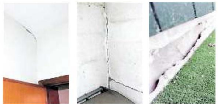
AL CONFINE La frazione di Praello e, qui sopra, alcune delle crepe che si sono aperte in alcune case
