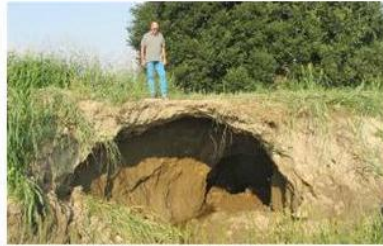
Frana sull'argine del Bussé causata dalle nutrie
