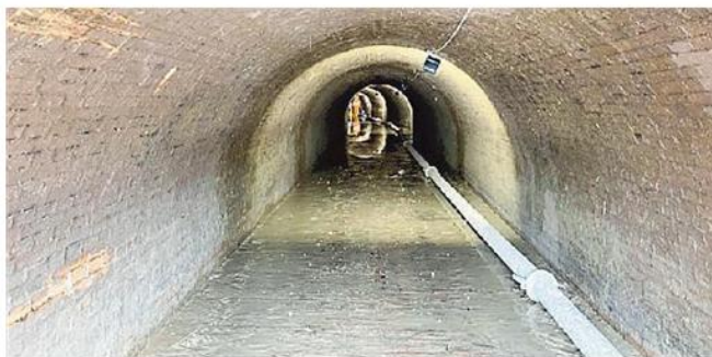
La botte a sifone che passa sotto l'alveo del fiume Brenta
