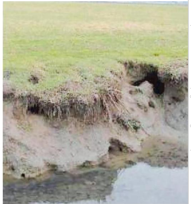
Un tunnel scavato dalle nutrie lungo l'argine di un canale
