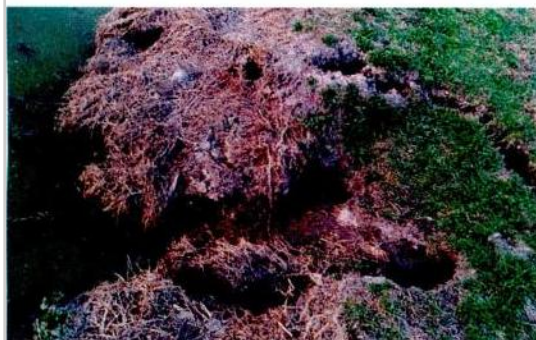
Un argine gravemente danneggiato dalle nutrie
