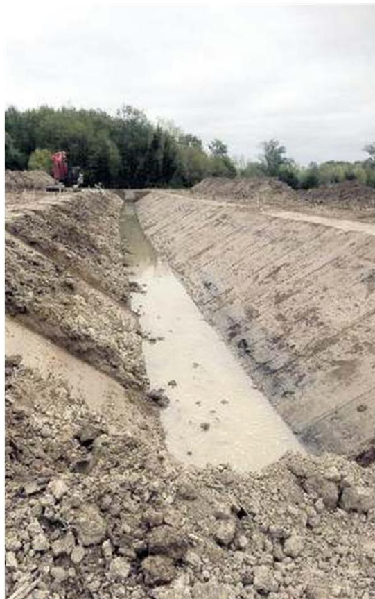
IL CANALE SCOLMATORE A Gruaro, da sud di via Volpi si estende verso sud per circa 1,4 chilometri, sottopassando la Provinciale 76 per giungere infine al fiume Lemene
