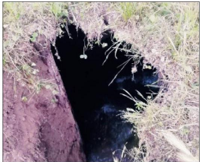
Il buco creato dalle nutrie sull'argine del Valdentro
