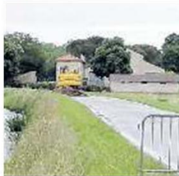
VIA VERDI Il punto dove si è aperta la falla sull'argine
