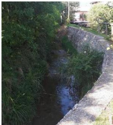
Rischio idraulico Un torrente misquiese invaso dalla vegetazione ARCHIVO
