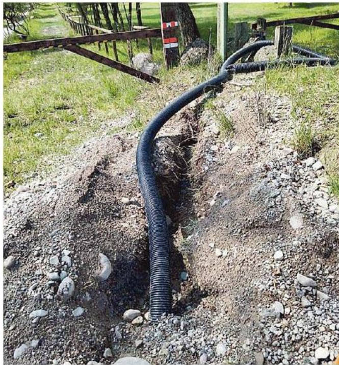
Il cavidotto contestato nella frazione di Santa Croce Bigolina
