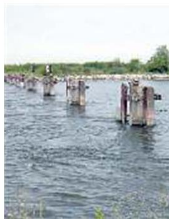
BONIFICA Barriere antisale sul fiume contro il cuneo salino
