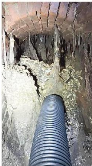
La roggia necessita di pulizia
