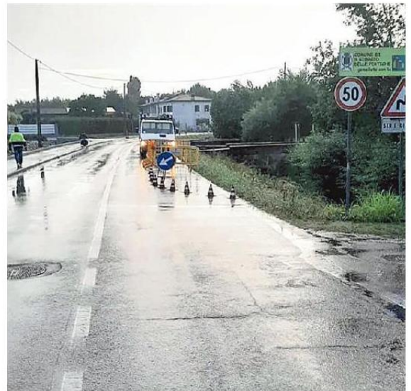
Il cedimento di via Anconetta a San Giorgio delle Pertiche
