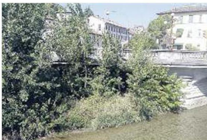
LA PREOCCUPAZIONE La vegetazione cresciuta a dismisura fa da tappo sotto a una delle arcate del ponte della Madonna
